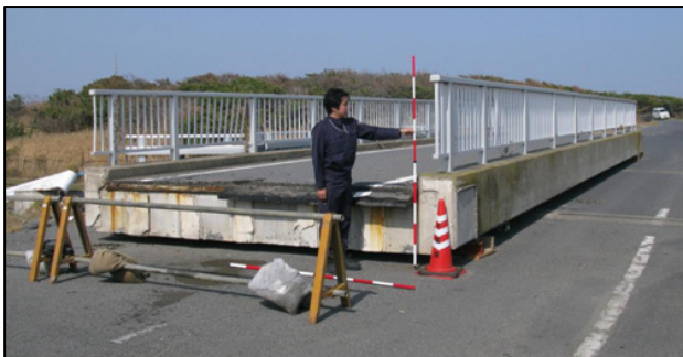
写真-1 流失した桁
