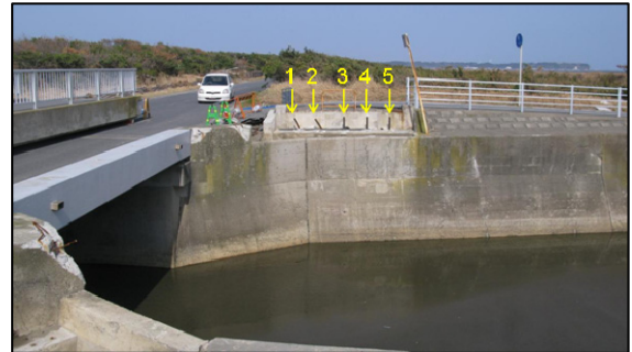
写真-2 桁流失後のアンカーバー
