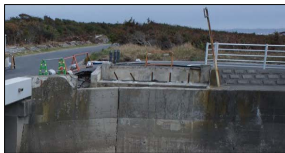
(b) 左岸側流失状況
